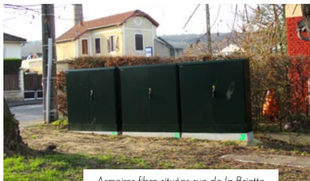
Armoires fibre situées rue de la Briette
